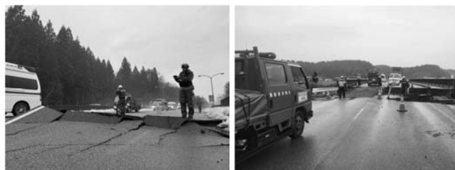
道路の被害状況
